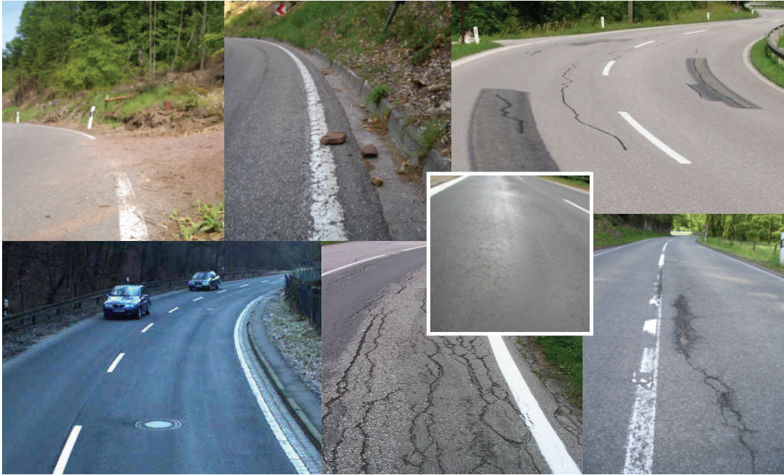
Bild 5: Überraschend auftretende Unstetigkeiten in der Fahrbahn insbesondere in Kurven als Risiko
