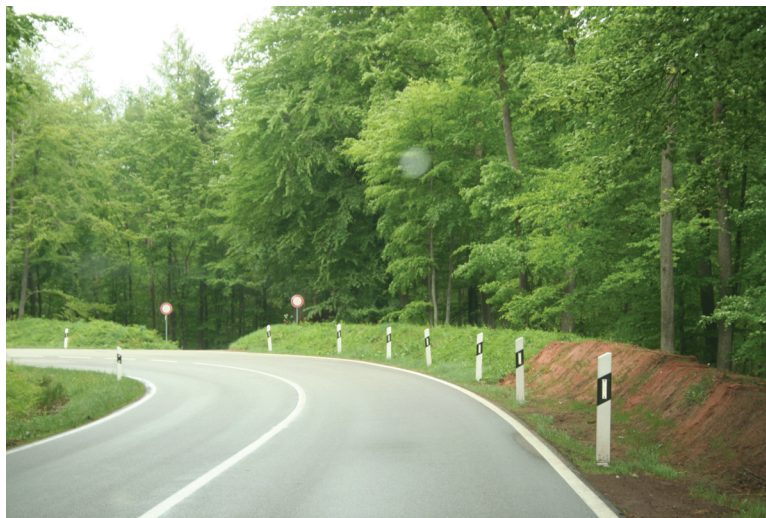
Bild 10: Verdichtet gestellte, nachgiebige Leitpfosten vor einem Erdwall statt Richtungstafeln mit Stahlpfosten
